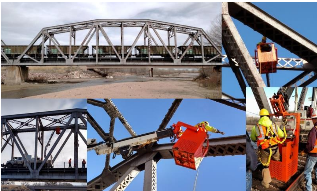
Rys. 9 Monitoring na przęsłach kratownicowych
